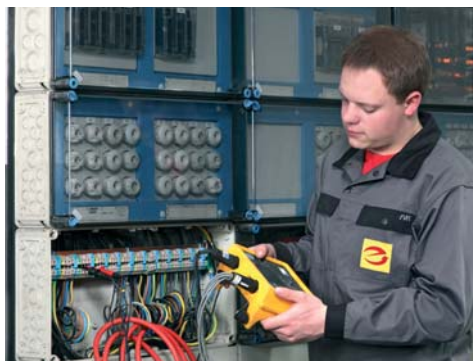
Электрические распределительные щиты до 630 А для установки электрических устройств (PSC) в соответствии со стандартом DIN EN 61 439 Часть 2
