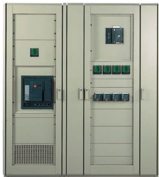
Главный распределительный щит
