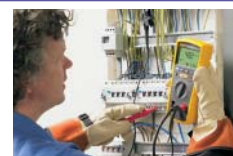
Проверка изоляции в распределительном щите
