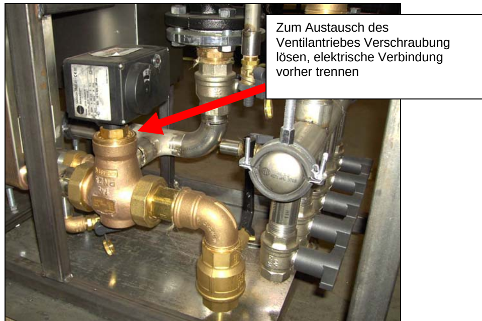
Abbildung: Rohrleitung ohne Isolierung
