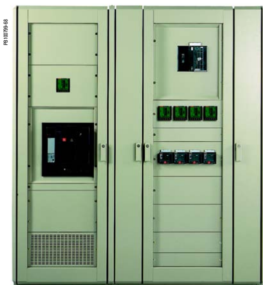
Главный распределительный щит низкого напряжения (ГРЩ)
